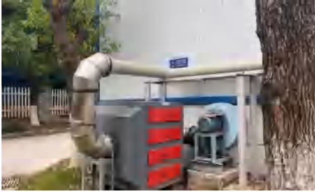
废气处理设施
