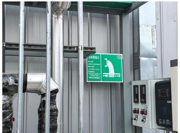
废水总排口 (DW003)
