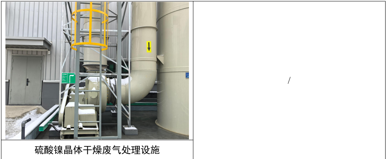
图 4.1-4 废气处理设施
