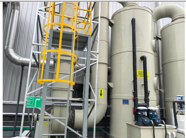
硫酸镍溶液/晶体酸性废气，氯化镍溶液酸性废气，氯化铜溶液酸性废气，硫酸储罐呼吸废气，盐酸储罐呼吸废气处理设施
