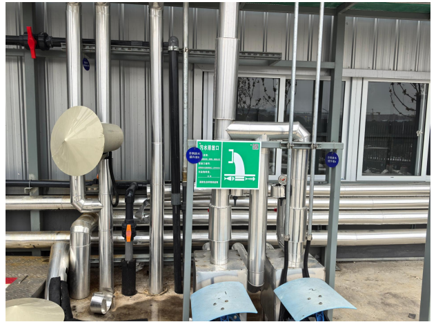
含铜废水车间排口 (DW002)
