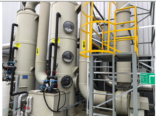
甲基磺酸亚锡酸性废气处理设施
